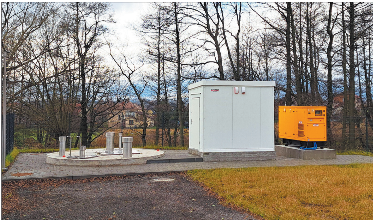
Pompownia „Huciska” przy ul. Galicyjskiej w Wilkowicach została już oddana do użytkowania, co stanowi kolejny kluczowy krok na finiszu inwestycji.
