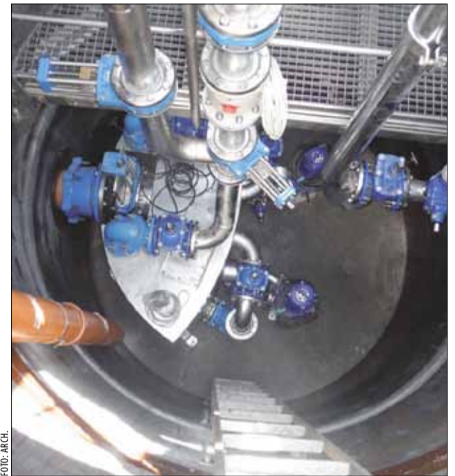
Nowoczesne pompownie – tłocznie ścieków w Huciskach i Bułgarii zapewnią możliwość skanalizowania prawie całych Wilkowic.
